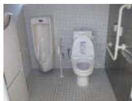
浄化槽での使用
